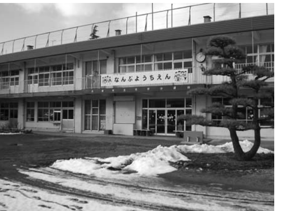
老朽化している南部幼稚園舎
