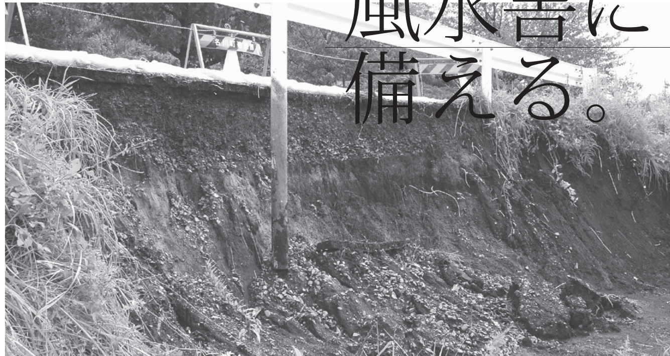
平成 18 年 10 月の大雨により崩落した町道
