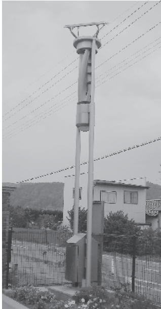
福地小学校の太陽光・風力発電設備（ハイブリット塔）
