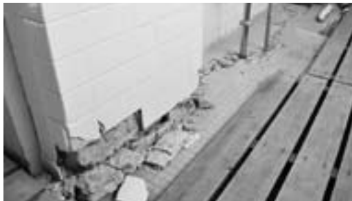
被害を受けた名川分庁舎2階のトイレ
