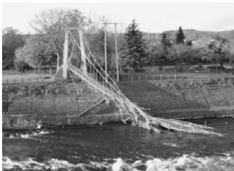
台風15号の影響による濁流で全壊した苦米地橋(つり橋)
