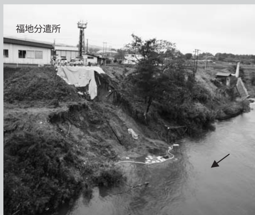
被害現場：福地橋から上流方向を撮影
