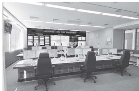
消防指令センター
