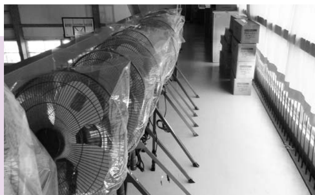
暑さ対策のため避難所に設置する扇風機
