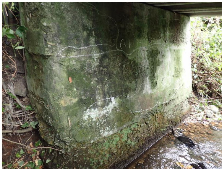
図3-5 凍害による損傷事例
