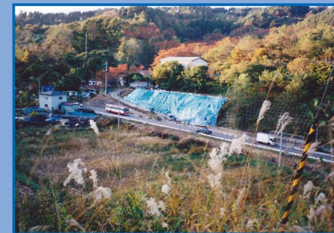
平成11年10月30日 伊勢沢公園入口付近の状況
