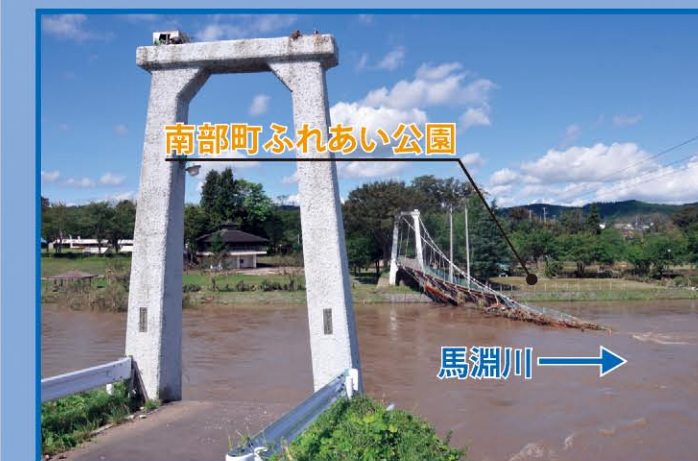
平成23年9月23日 南部町ふれあい公園付近のつり橋の被災状況
