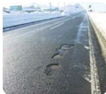
路面の穴ぼこ・ 段差
