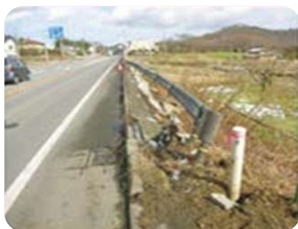
ガードレール・ 標識等の損傷
