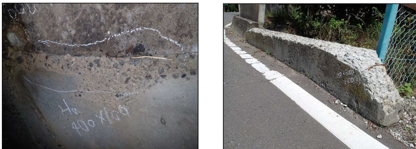
図3-5 凍害による損傷事例
